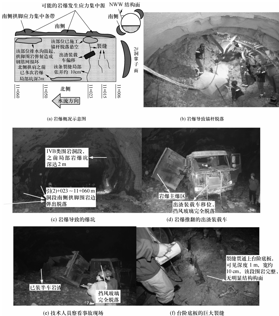
图 13 锦屏二级水电站岩爆现场
